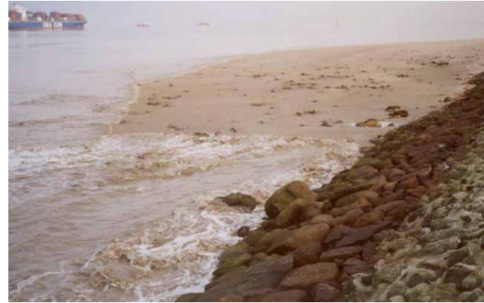
Erodierte Deckwerkssteine auf dem Vorstrand östlich Glameyer Stack (2004), Quelle: BAW
