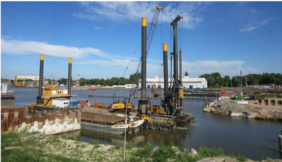
Der Ponton für das Bohrgerät im Bereich des Binnenhauptes hält sich mit Stelzen auf seiner Position. Im Hintergrund die Anlegestelle der Baustellenfähre und die kanalseitige Zufahrt zu den kleinen Schleusen.
