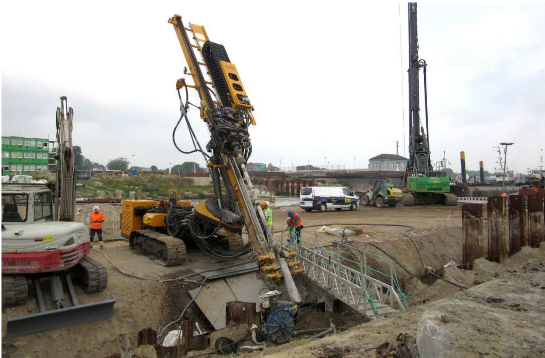
Im 45-Grad-Winkel wird für die Düsenstrahlpfähle in den Boden gebohrt. Von 300 Pfählen für die Verankerung beider Kammerwände sind bislang rund 50 fertig.
