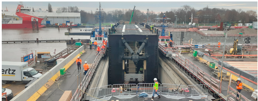
Blick aus Richtung Torhaus auf Tor VII, das über den Dremmel in die Torkammer gleitet.
