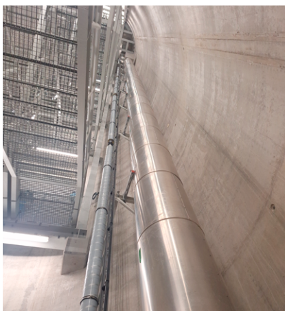
Treppenschacht mit vertikaler Trinkwasserleitung.
