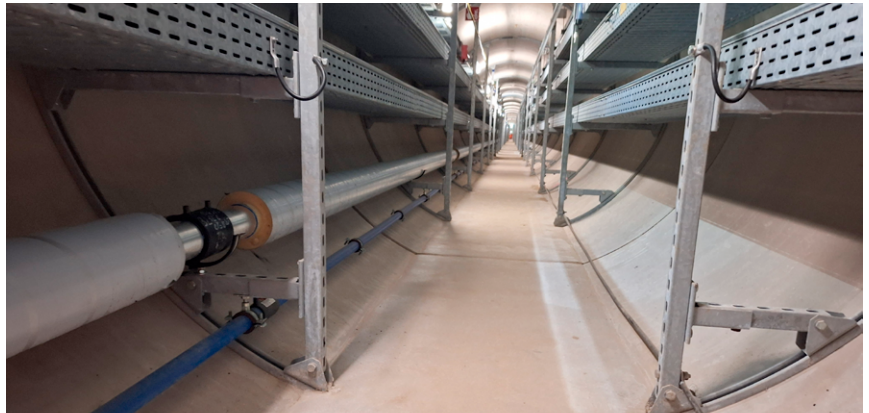
Im zentralen Leitungstunnel 32 Meter unter der Schleusenanlage verläuft die Trinkwasserleitung.
