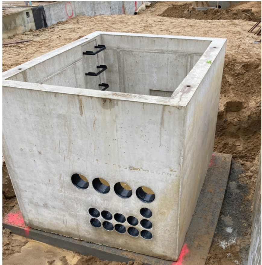
Begehbare Kabelziehschächte: Stahlbetonfertigteile bilden die Zugänge zu den unterirdischen Stromleitungen.
