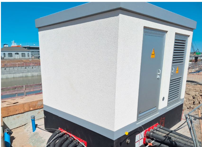
Knotenpunkte: In den Trafogebäuden wird Mittelspannung in verbrauchsübliche Niederspannung umgewandelt.
