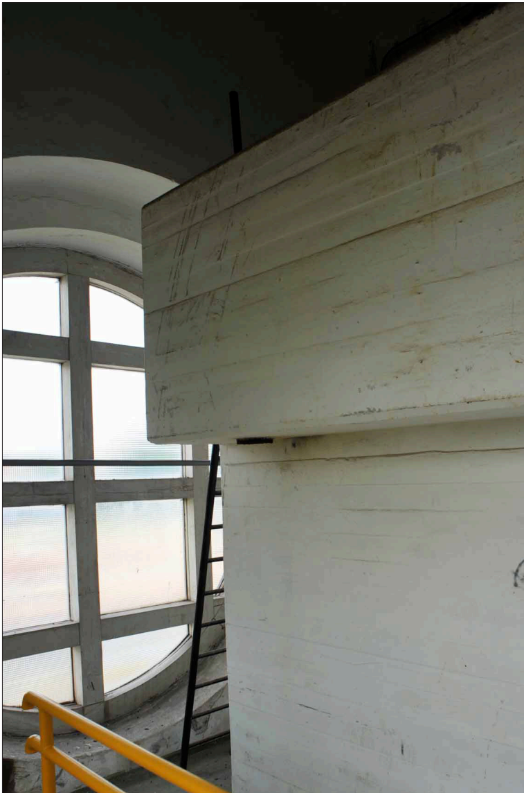
Bild 14 Nordfenster und Trinkwasser-Enteisungsanlage
