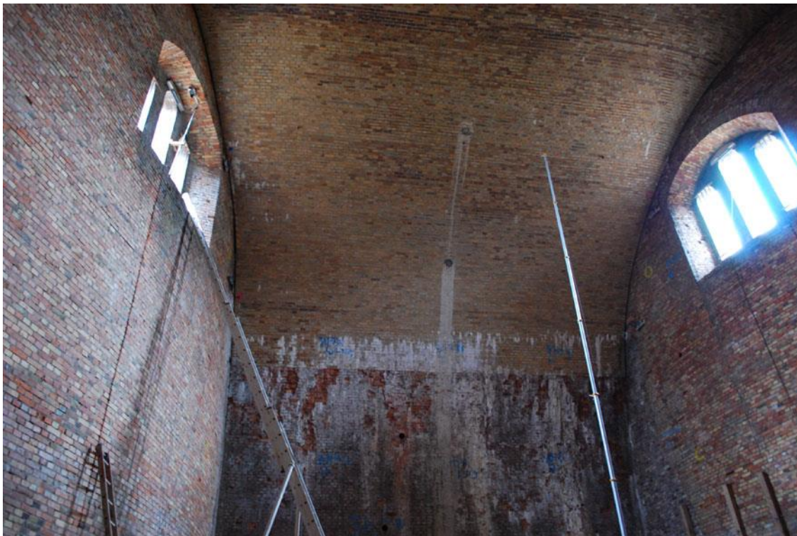
Abb. 4: Außenansicht der Fenster-Einflugöffnungen (oben) sowie Übersicht des Gewölbeinnenraumes mit den besiedelten Fledermausspalten im Bogen über den Fenstern sowie den senkrechten, phasenweise besiedelten Mauerspalten unter den Fenstern.
