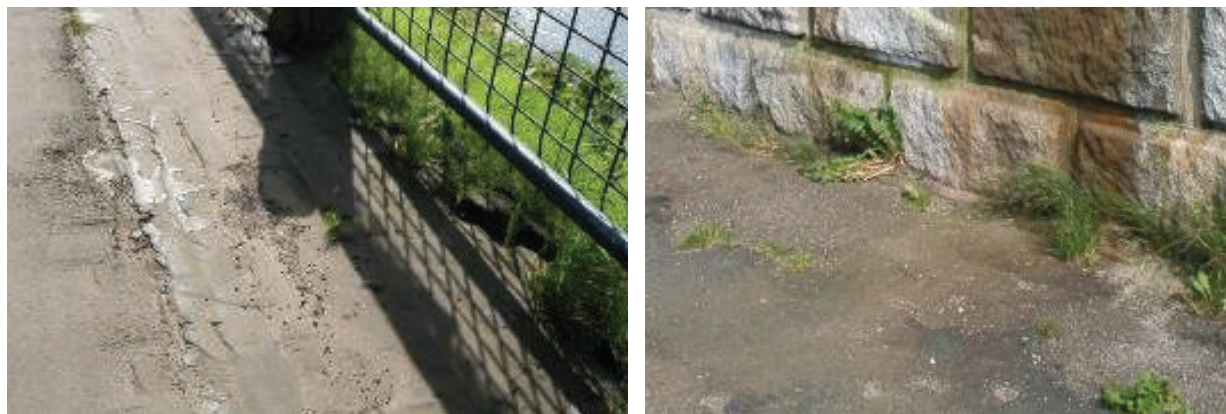
Abbildung 7: Asphaltdecke unter dem Widerlager Süd an der Böschungskante (links) und der Widerlageseite (rechts)
