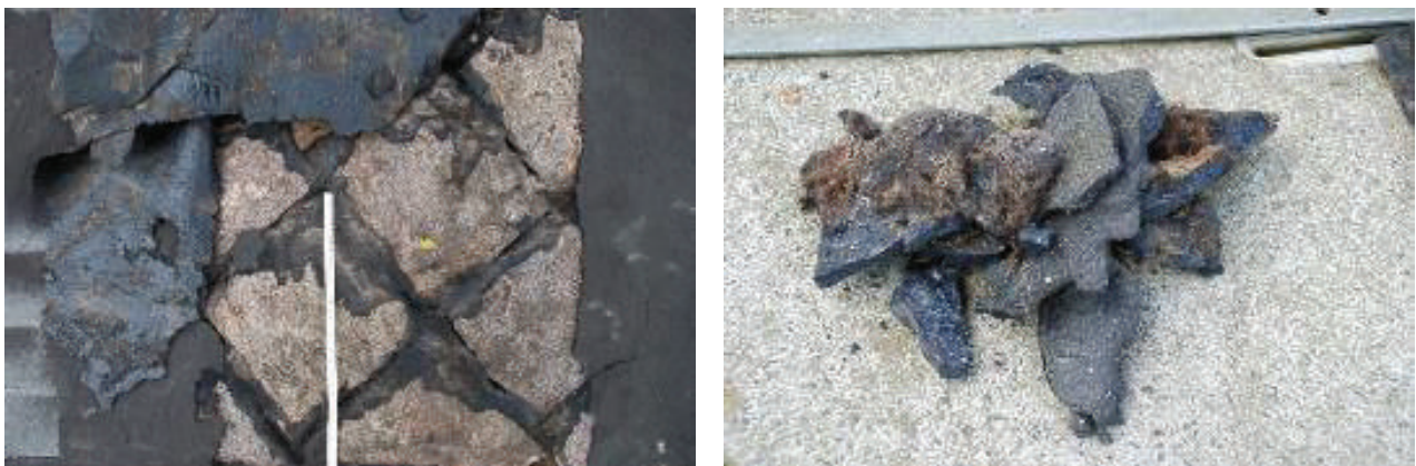
Abbildung 6: Granitpflaster auf der Böschung am Widerlager Nord (BS13), herausgelöste Fugenvergussmasse (BS11)
