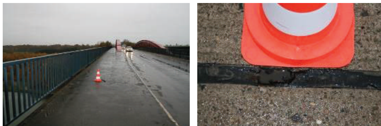
Abbildung 4: Betonfläche und Fahrbahn auf dem Fußgängerweg am Widerlager Süd mit Fuge (links) und Fugenmasse (rechts)
