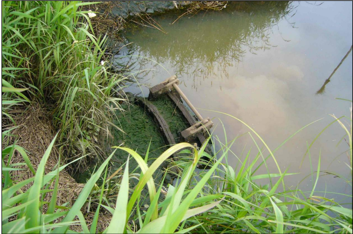
Foto 14: Entwässerungsrohr mit einseitiger Klappe in dem Bereich des geplanten Sommerdeichdurchbruchs im Maßnahmengebiet SH 1f Siethfeld (15.06.2009)
